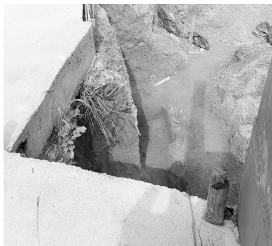
Bomberos Voluntários de São Domingos do Prata BARRANCO desabou durante obra, matando funcionário
